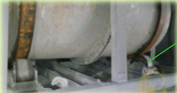
锅炉冷渣机托轮干摩擦
